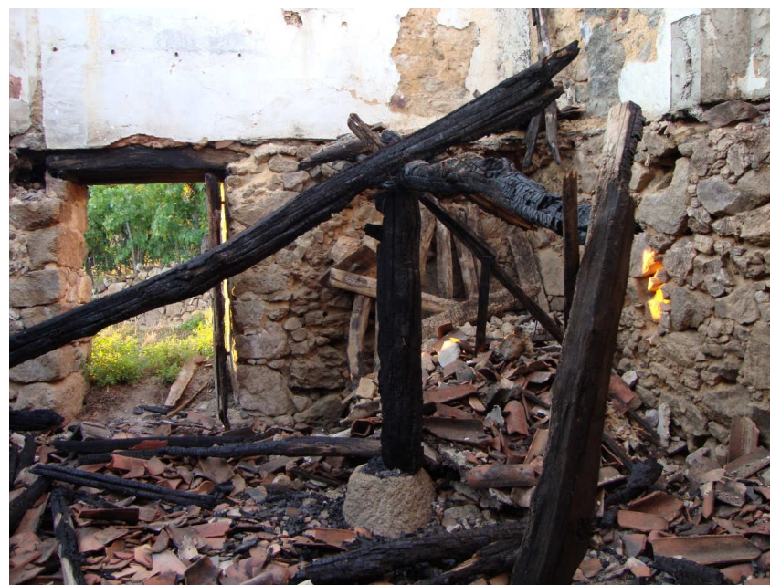
Vista do interior após o incêndio de 2017
