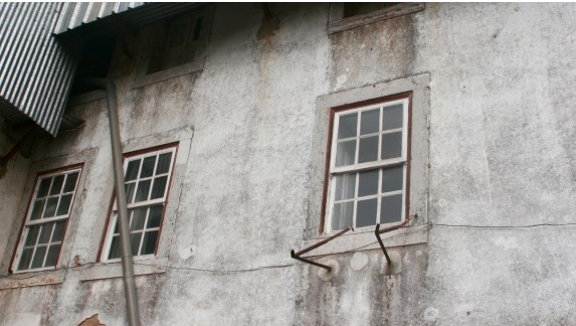
Figura 129. Segundo corpo. Vista superior - Manchas de humidade generalizadas - Desagregação do revestimento da parede fonte: Fotografia facultada pela CML. PA n.º 394/DOM (2007)
