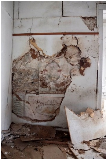
Figura 90. Sala da República. Parede interior - Eflorescências na parede - Empolamento da pintura fonte: Autor (2016)
