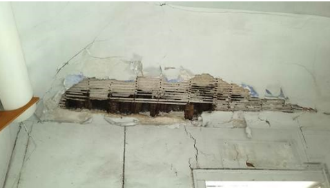
Figura 85. Teto na sala da República - Empolamento da pintura na parede - Desagregação dos materiais de acabamento no teto - Vestígios de humidade no teto - Madeiras desagregadas e podres no teto fonte: Fotografia da CML. PA n.º 394/DOM-D (2007)
