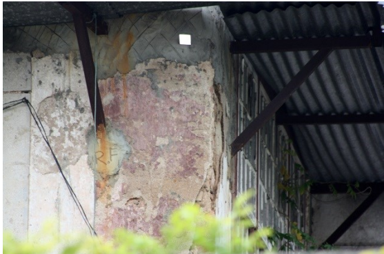
Figura 118. Cunhal da fachada no interior do conjunto - Desagregação do reboco - Deslocamento do revestimento do cunhal do edifício fonte: Autor (2016)
