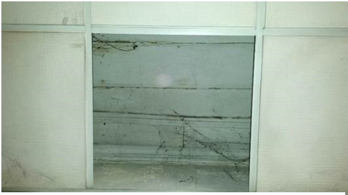
Figura 94. Teto na sala a noroeste - Vestígios de humidade - Empolamento da pintura no revestimento do teto fonte: Autor (2016)
