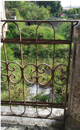
Figura 140. Elementos decorativos da varanda - Oxidação dos elementos metálicos fonte: Autor (2016)
