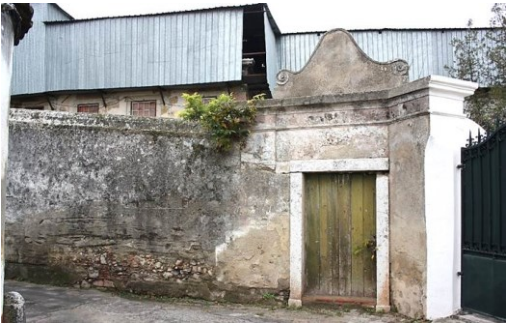
Figura 114. Acesso pela Travessa do Pinhal - Desagregação do reboco - Existência de vegetação - Manchas de humidade na parede - Empolamento da pintura na porta fonte: Autor (2016)
