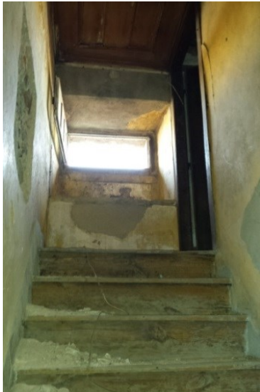
Figura 102. Escada -Desagregação do revestimento na parede - Vestígios de humidade na parede - Empolamento da pintura na janela - Escada com ligeira deformação e desgaste de utilização fonte: Autor (2016)
