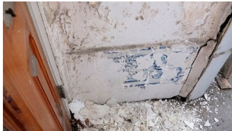
Figura 86. Parede da sala - Empolamento na parede - Eflorescência na parede - Fendilhação vertical na parede - Desagregação do azulejo fonte: Autor ( 2016)
