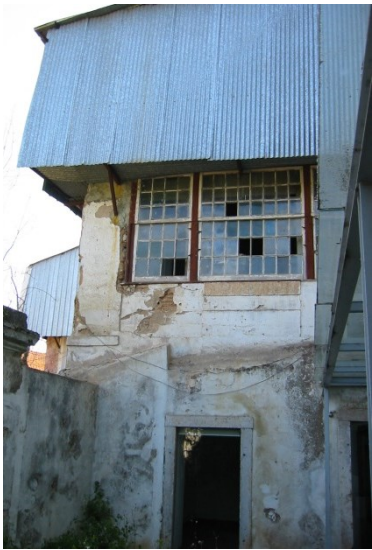
Figura 141. Fachada posterior. Pátio - Degradação do reboco - Caixilharia de madeira em mau estado - Vestígios de humidade na parede - Vidros partidos - Empolamento da pintura na parede fonte: Fotografia facultada pela CML. PA n.º 394/DOM-D (2007)
