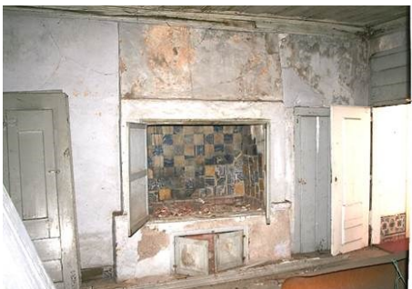
Figura 87. Cozinha antiga-02 - Fendilhação horizontal na parede - Empolamento da pintura nas guarnições e porta - Vestígios de humidade - Desagregação do revestimento na parede fonte: Fotografia da CML. PA n.º 394/DOM-D (2007)
