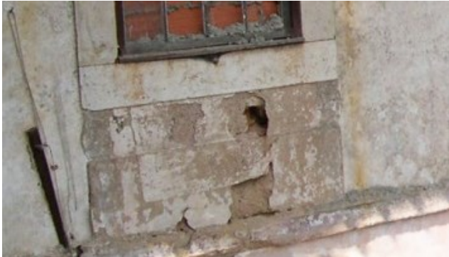
Figura 119. Detalhe da janela - Deslocamento do silar - Vestígios de humidade na parede e cantaria - Desagregação do friso - Vidros partidos fonte: Autor (2016)
