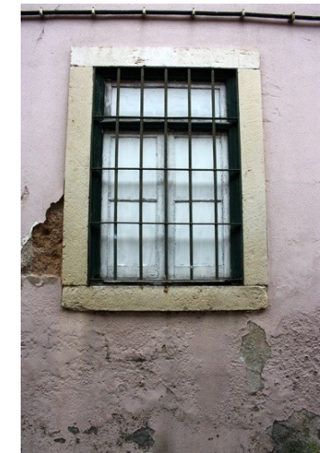
Figura 111. Janela - Empolamento da pintura na parede - Desagregação do reboco - Oxidação do gradeamento - Degradação da madeira fonte: Autor (2016)
