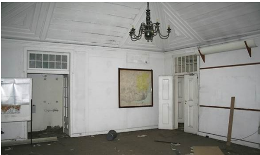
Figura 95. Sala - Fendilhação horizontal na parede - Empolamento da pintura nas guarnições e porta - Vestígios de humidade - Desagregação do revestimento na parede fonte: Fotografia facultada pela CML. PA n.º 394/DOM-D (2007)
