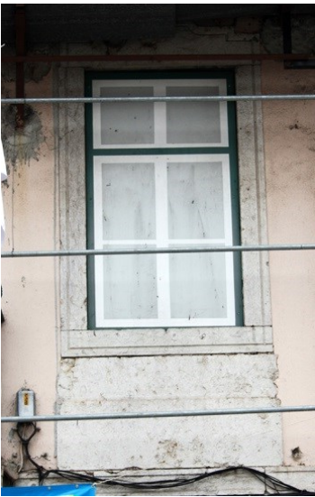
Figura 105. Elementos pétreos - Fendilhação vertical no silar - Vestígios de humidade nas cantarias fonte: Autor (2016)
