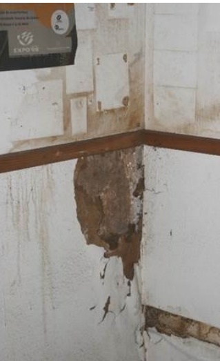
Figura 91. Sala da República. Parede exterior - Eflorescências na parede - Fungos de podridão na madeira fonte: Autor (2016)
