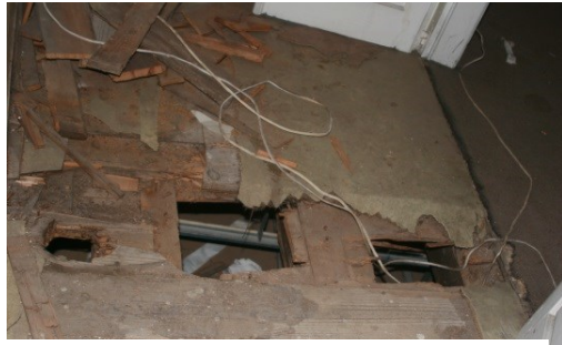
Figura 93. Pavimento no corredor - Indícios de ataque de xilófagos e podridão - Soalho na face superior deteriorado fonte: Fotografia da CML. PA n.º 394/DOM (2007)
