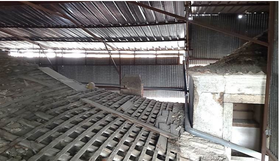
Figura 127. Cobertura - Fendilhação horizontal na cantaria - Cornija degradada - Desagregação do revestimento da parede fonte: Autor (2016)
