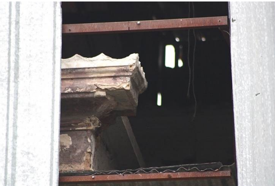
Figura 137. Cornija no corpo primitivo - Cornija com sinais evidentes de degradação fonte: Autor (2016)
