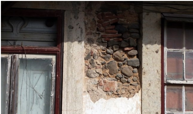
Figura 121. Elementos da fachada - Desagregação do revestimento da parede - Vidros partidos - Degradação das madeiras fonte: Autor (2016)
