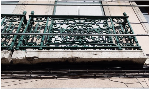
Figura 109. Serralharias e cantarias-02 - Fendilhação vertical da cantaria na varanda - Corrosão dos elementos metálicos da varanda - Vestígios de humidade na parte inferior da varanda fonte: Autor (2016)
