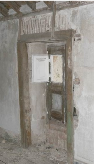
Figura 99. Elementos verticais - Desagregação do revestimento na parede - Vidros partidos - Desagregação dos azulejos - Desaprumo do vão - Madeira em mau estado fonte: Fotografia facultada pela CML. PA n.º 394/DOM (2007)
