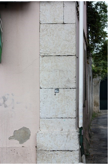
Figura 106. Cunhal do edifício - Empolamento da pintura na parede - Manchas de humidade na cantaria fonte: Autor (2016)
