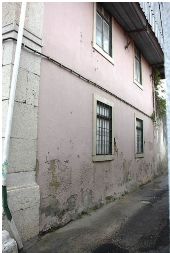
Figura 112. Fachada lateral direita - Empolamento da pintura na parede - Manchas de humidade nas cantarias e parede fonte: Autor (2016)
