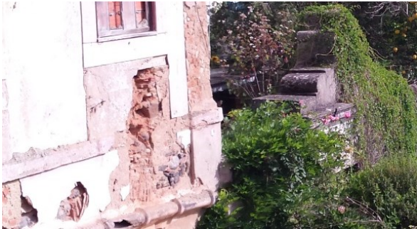
Figura 125. Detalhe da fachada - Desagregação do reboco fonte: Autor (2016)
