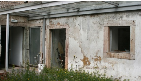
Figura 128. Segundo corpo. Vista inferior - Eforescências na parede - Vestígios de humidade na parede e cantarias - Desagregação do reboco - Empolamento da pintura fonte: Fotografia facultada pela CML. PA n.º 394/DOM (2007)
