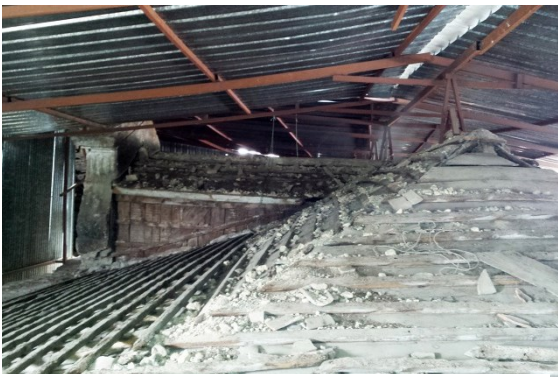
Figura 138. Cobertura - Vestígios de humidade na mansarda - Desagregação do revestimento na parede - Degradação de parte dos elementos em madeira da cobertura fonte: Autor (2016)
