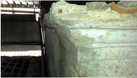
Figura 124. Cornija no segundo corpo - Cornija degradada fonte: Autor (2016)
