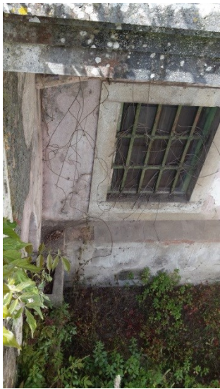
Figura 139. Interior do tanque - Existência de vegetação - Infestação biológica - Oxidação dos elementos metálicos fonte: Autor (2016)
