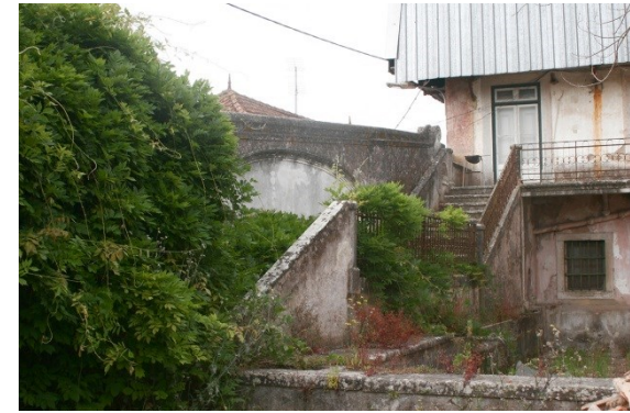
Figura 131. Muro vista interior - Existência de vegetação - Oxidação da guarda em ferro forjado - Vestígios de humidade no murete da escada fonte: Fotografia facultada pela CML. PA n.º 394/DOM (2007)
