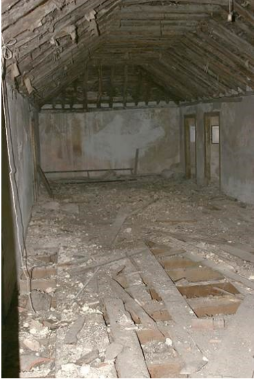
Figura 98. Sala no segundo corpo-01 - Fendilhação e degradação dos azulejos - Vestígios de humidade generalizado na parede. - Eflorescências e empolamentos do reboco fonte: Fotografia facultada pela CML. PA n.º 394/DOM-D (2007)
