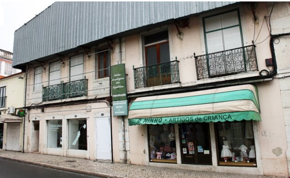
Figura108. Fachada principal - Cornija com sinais evidentes de degradação - Fendilhação vertical na parede - Vestígios de humidade nas cantarias - Empolamentos na parede fonte: Autor (2016) Fotografia do autor, Janeiro de 2016
