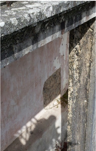
Figura 133. Elemento estrutural da varanda - Fendilhação vertical no pilar - Vestígios de humidade na cantaria - Eflorescências no pilar fonte: Autor (2016)
