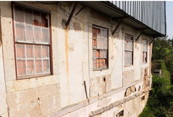
Figura 120. Fachada lateral direita. Vista superior - Descolamento dos silares - Vestígios generalizados de humidade - Desagregação do revestimento nas paredes - Elementos metálicos na fachada com sinais de corrosão fonte: Autor (2016)
