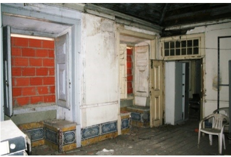
Figura 83. Sala das Conversadeiras - Vestígios de humidade na parede - Fendilhação horizontal na parede - Empolamento da pintura na porta - Ausência de caixilharia exterior - Fendilhação nos azulejos - Desagregação do revestimento na parede fonte: Fotografia da CML. PA n.º 394/DOM-D (2007)
