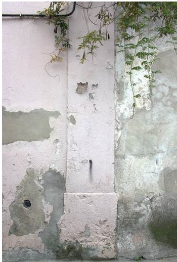
Figura 113. Remate do edifício com o muro - Empolamento da pintura na parede - Desagregação do reboco - Fendilhação oblíqua na parede - Existência de vegetação fonte: Autor (2016)
