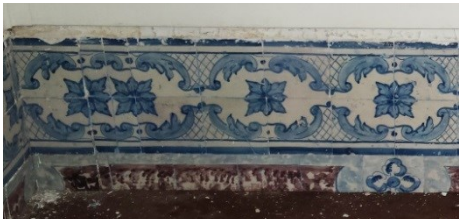
Figura 81. Lambriel de azulejo na sala nordeste - Fendilhação vertical no azulejo - Eflorescência na parede fonte: Fotografia da CML. PA n.º 394/DOM-D (2007)
