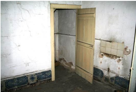
Figura 82. Ante-câmara - Fendilhação oblíqua na parede - Desagregação do azulejo - Desagregação do revestimento na parede - Vestígios de humidade na parede fonte: Fotografia da CML. PA n.º 394/DOM-D (2007)
