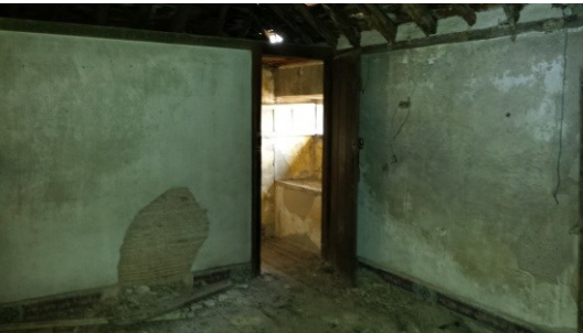
Figura 101. Sala no segundo corpo-02 - Fendilhação e degradação dos azulejos - Vestígios de humidade generalizado na parede - Desagregação do revestimento na parede - Eflorescências e empolamentos do reboco fonte: Autor (2016)
