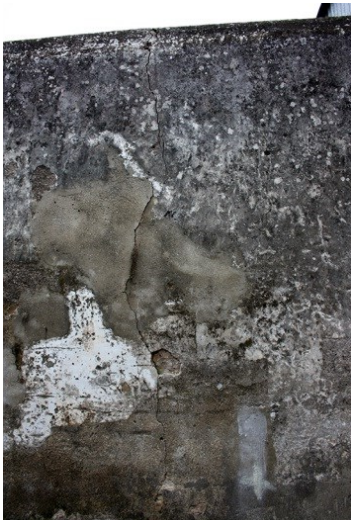
Figura 116 Muro confinante com a Travessa do Pinhal - Fendilhação vertical na parede - Manchas de humidade - Desagregação do reboco - Eflorescências na parede fonte: Autor (2016)
