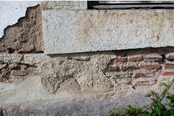
Figura 135. Parede e cantaria - Vestígios de humidade na parede - Desagregação do revestimento da parede fonte: Autor (2016)
