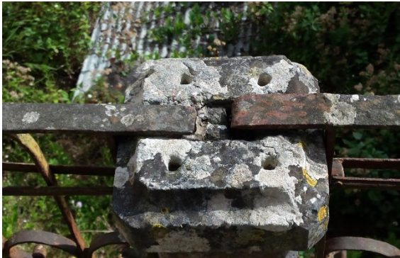
Figura 134. Elemento decorativo da varanda - Infestação biológica - Oxidação dos elementos metálicos fonte: Autor (2016)
