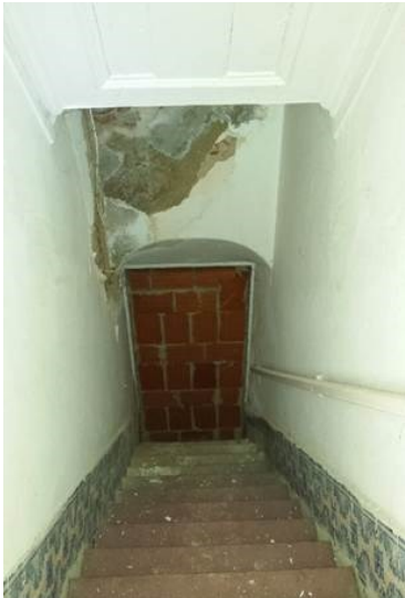
Figura 77. Acesso ao primeiro piso Elevado - Fendilhação em alguns azulejos - Vestígios de humidade generalizada na parede - Desagregação do revestimento na parede fonte: Autor (2016)
