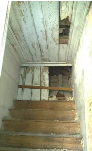
Figura 92. Louceiro - Degraus em razoável estado de conservação - Empolamento da pintura no revestimento da madeira - Desagregação do revestimento na cobertura fonte: Autor (2016)
