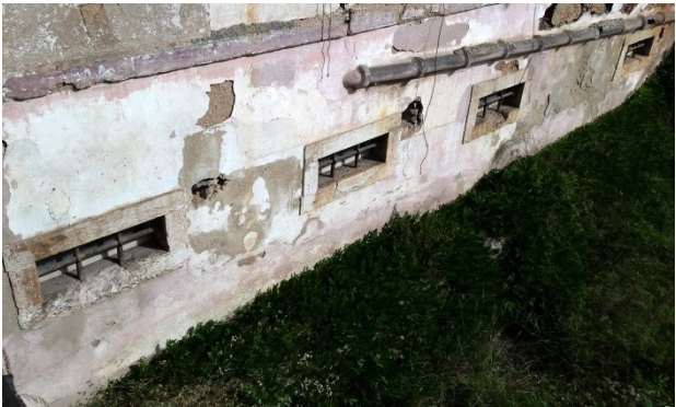
Figura 122. Fachada lateral direita. Vista inferior - Eflorescências na parede - Empolamento da pintura na parede - Vestígios de humidade - Existência de vegetação no pavimento do tanque fonte: Autor (2016)
