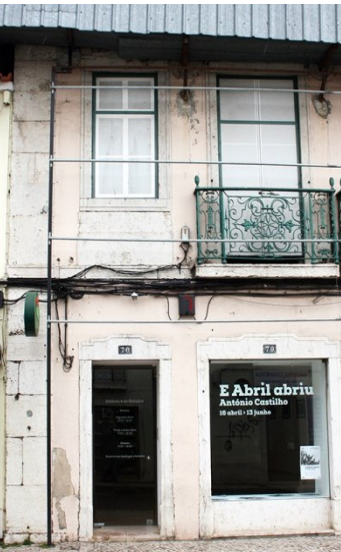
Figura 104. Fachada principal parcial - Manchas de humidade nas cantarias - Desagregação do reboco - Eflorescências na parede fonte: Autor (2016)
