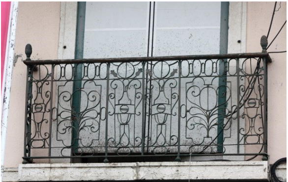
Figura 107. Serralharias e cantarias-01 - Fendilhação na cantaria - Corrosão dos elementos metálicos - Madeira que encima as guardas com sinais de podridão fonte: Autor (2016)
