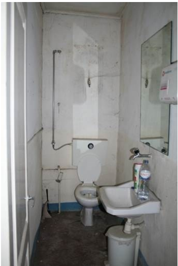
Figura 89. Instalação sanitária - Vestígios de humidade na parede - Empolamento da pintura na parede fonte: Fotografia facultada pela CML. PA n.º 394/DOM-D (2007)
