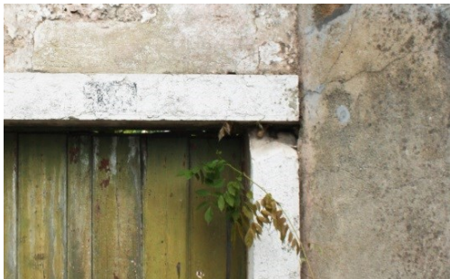
Figura 115. Verga da porta - Fendilhação horizontal na parede - Eflorescências na parede - Existência de vegetação fonte: Autor (2016)
