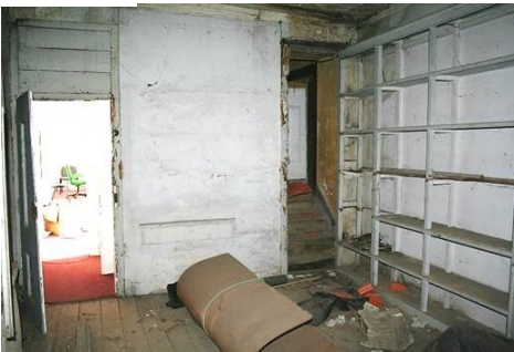
Figura 84. Cozinha antiga-01 - Fendilhação horizontal na parede - Empolamento da pintura nas guarnições e porta - Vestígios de humidade - Desagregação do revestimento na parede fonte: Fotografia da CML. PA n.º 394/DOM-D (2007)
