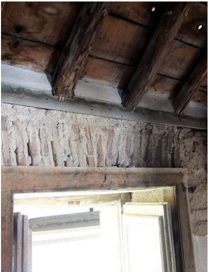
Figura 97. Ligação da cobertura com a parede - Desagregação do revestimento na parede - Vigamento e revestimento em madeira com sinais evidentes de podridão fonte: Autor (2016)
