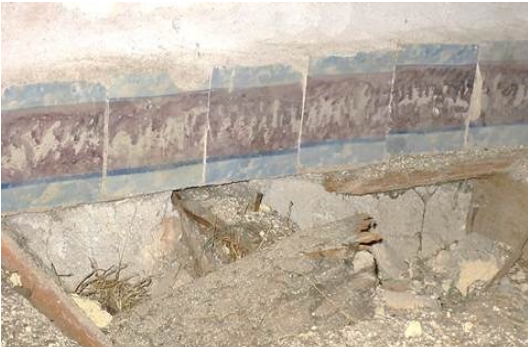
Figura 100. Ligação do pavimento com a parede - Desagregação do pavimento em madeira - Azulejo danificado fonte: Fotografia facultada pela CML. PA n.º
