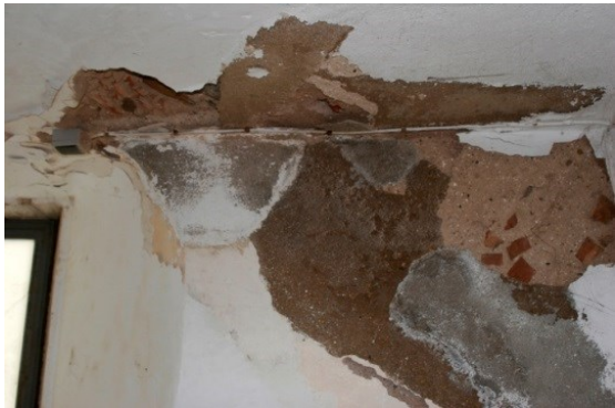
Figura 79. Parede interior no segundo corpo - Vestígios de humidade generalizada na parede - Desagregação do revestimento na parede fonte: Fotografia da CML. PA n.º 394/DOM (2007)
