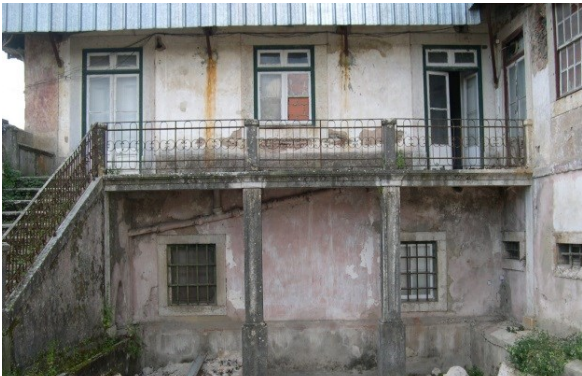
Figura 132. Fachada posterior - Oxidação da guarda em ferro forjado - Vestígios de humidade na parede e cantarias - Empolamento da pintura fonte: Fotografia facultada pela CML. PA n.º 394/DOM (2007)
