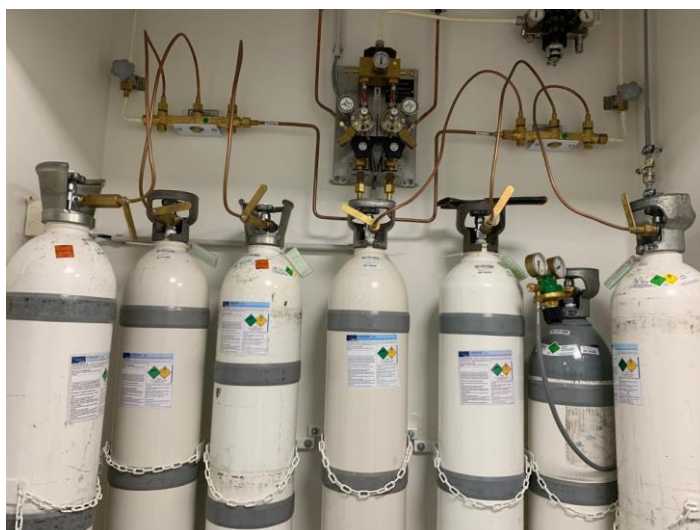
Figura 4. Circuito de Garrafas de Oxigénio que Fornece a Câmara Hiperbárica (Fotografia gentilmente cedida pelo CR 2 AL).
