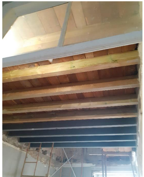
Figura 99. Largo Dr. José Barbosa, prumos e vigas de suporte de teto em colapso
