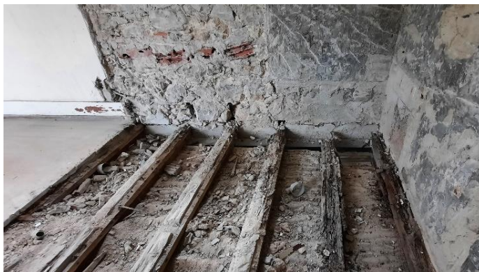
Figura 104. Edf. Largo Dr. José Barbosa, estado das vigas de pavimento
