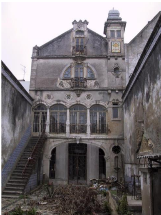
Figura 38. Casa Major Pessoa, fachada posterior antes da reabilitação
