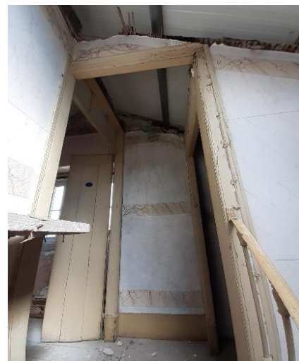
Figura 81. Edf. Largo Dr. José Barbosa, pormenor do estado de parede interior
