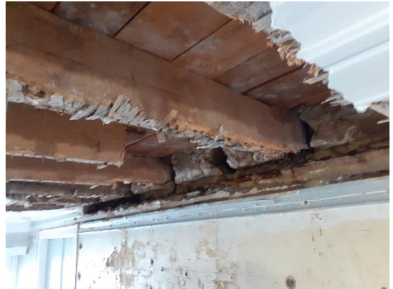
Figura 97. Edf. Largo Dr. José Barbosa, pormenor do estado de degradação da madeira
