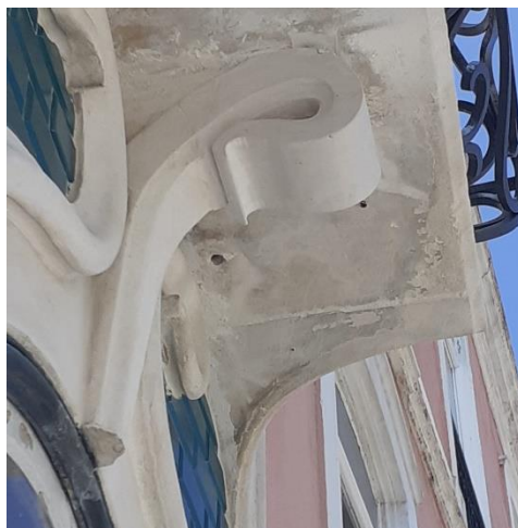
Figura 73. Edf. Largo Dr. José Barbosa, pormenor das cantarias antes da intervenção
