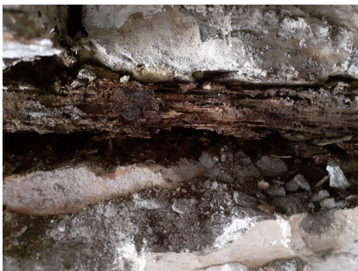
Figura 67. Edif. Largo Dr. José Barbosa, estado da viga de madeira de cintagem
