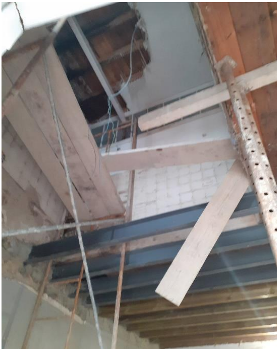
Figura 98. Largo Dr. José Barbosa, prumos e vigas de suporte de teto em colapso
