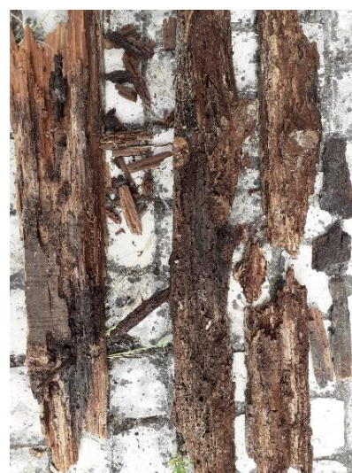
Figura 68. Edif. Largo Dr. José Barbosa, estado da viga
