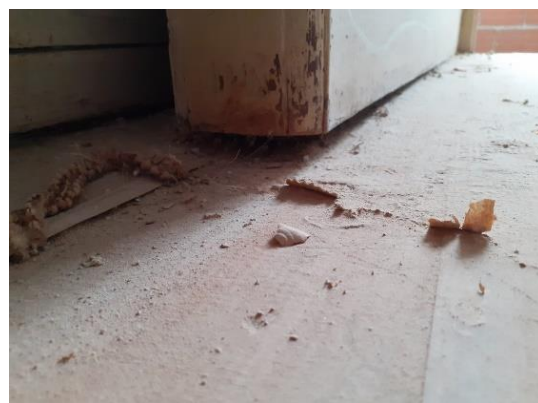
Figura 66. Edf. Largo Dr. José Barbosa, fratura do piso da cozinha
