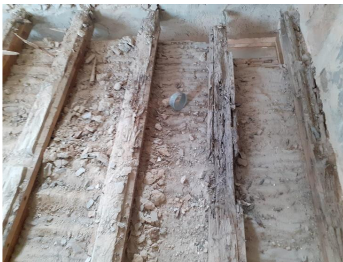
Figura 70. Edf. Largo Dr. José Barbosa, estado das vigas de madeira de pavimento do espaço 3
