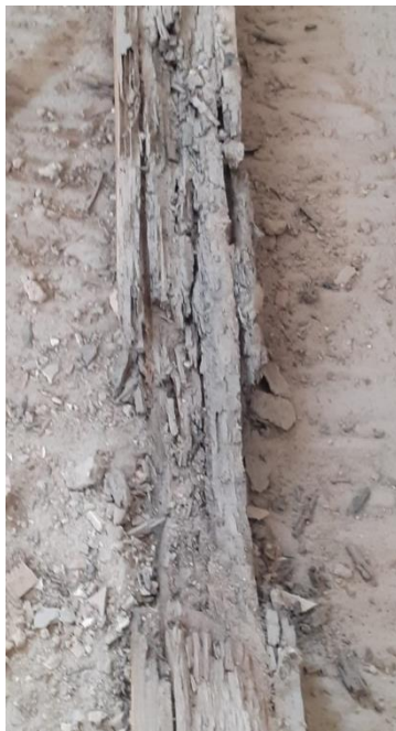
Figura 87. Edf. Largo Dr. José Barbosa, pormenor do estado de degradação da madeira
