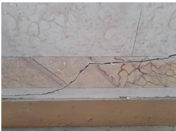
Figura 80. Edf. Largo Dr. José Barbosa, pormenor do estado de parede interior e estuque
