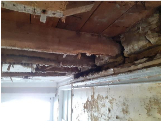
Figura 96. Edf. Largo Dr. José Barbosa, pormenor do estado de degradação da madeira
