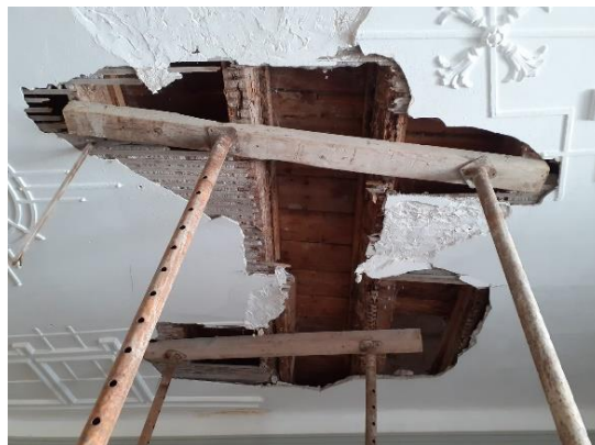
Figura 95. Edf. Largo Dr. José Barbosa, prumos e vigas de suporte de teto em colapso
