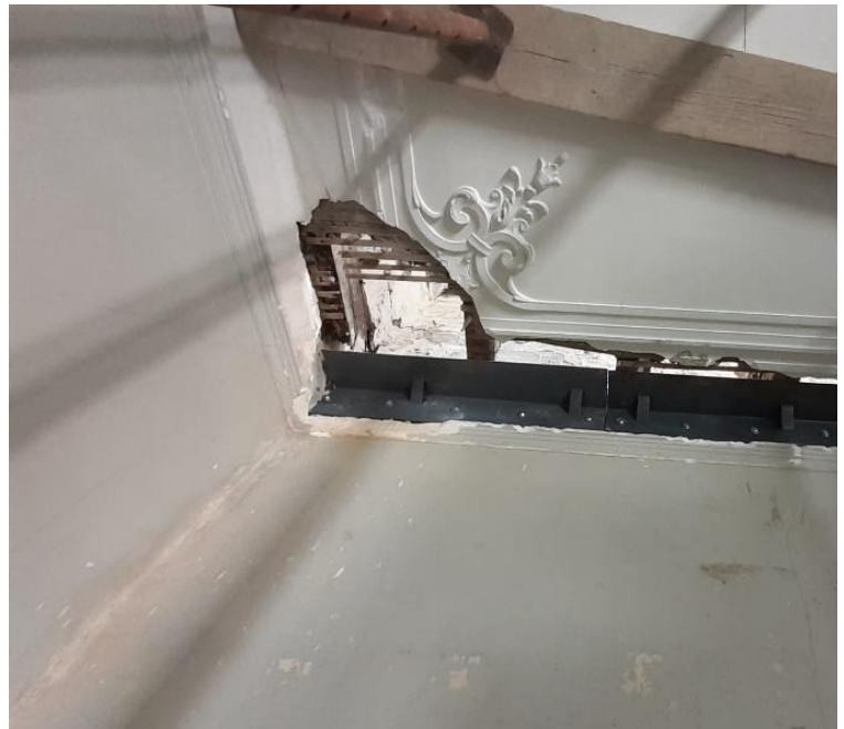
Figura 88. Edf. Largo Dr. José Barbosa, reforço de cantoneira de ferro de suporte das vigas
