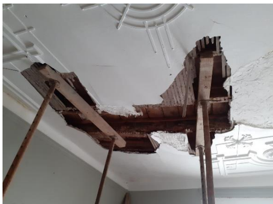
Figura 94. Edf. Largo Dr. José Barbosa, prumos e vigas de suporte de teto em colapso
