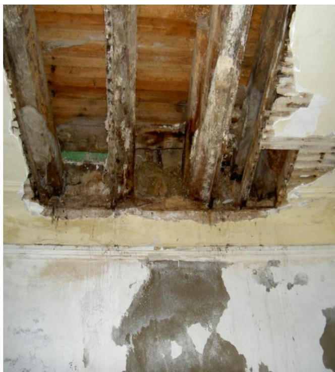
Figura 22. Casa Major Pessoa, deterioração das vigas de madeira
