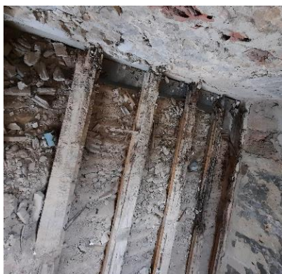
Figura 103. Edf. Largo Dr. José Barbosa, estado das vigas de pavimento
