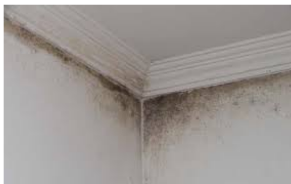
Figura 12 Condensação nas paredes
