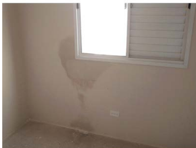
Figura 11 Humidade proveniente da precipitação
