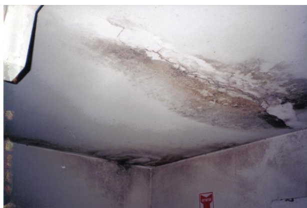
Figura 13 Infiltração nas paredes proveniente da cobertura
