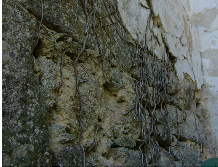
Fig.40 Desagregação granular. Foto do autor.
