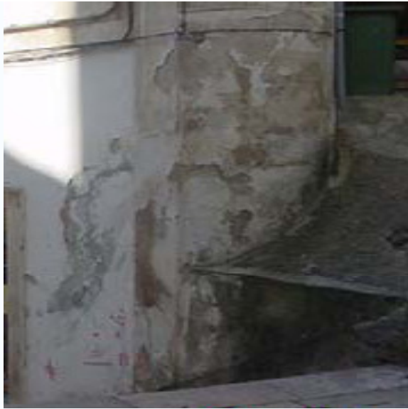
Fig.17 Escolha de materiais incompatíveis em revestimentos exteriores.
