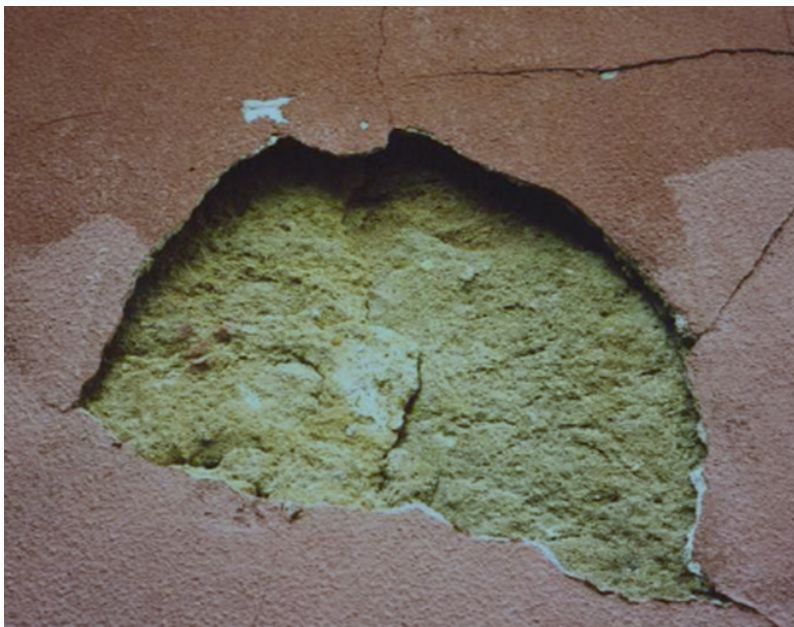
Fig.19 Parede revestida com argamassa de cal, incompatível com reboco de cimento.
