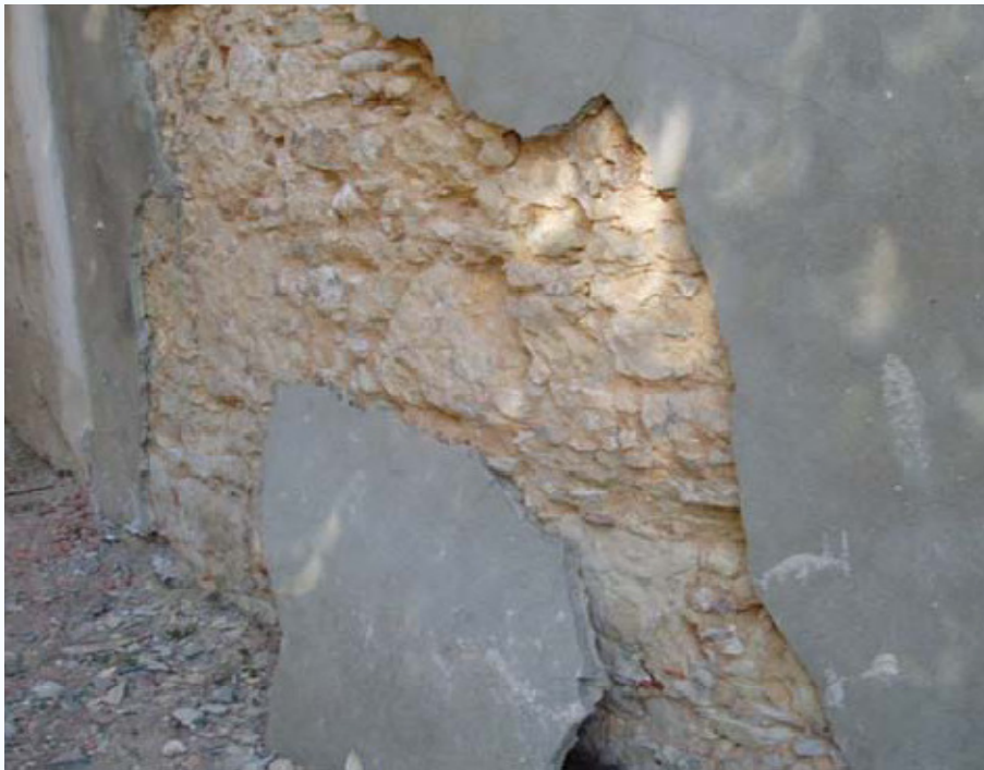
Fig.35 Incompatibilidade do reboco de cimento, com alvenaria antiga com ligante em cal.
