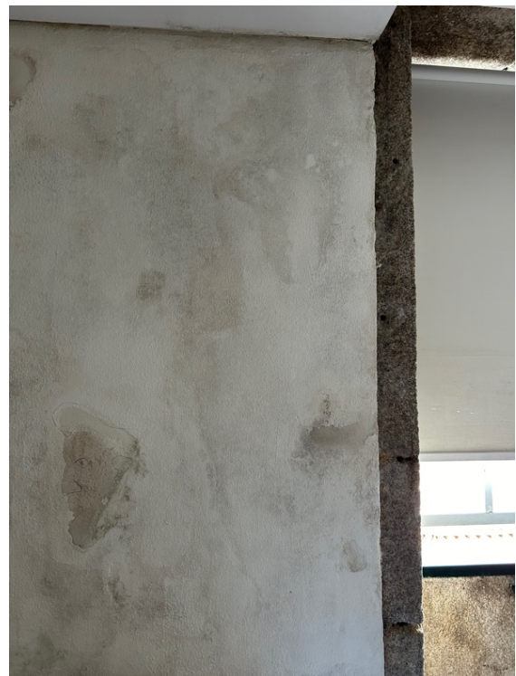
Figura 51: Humidade na prede interior
