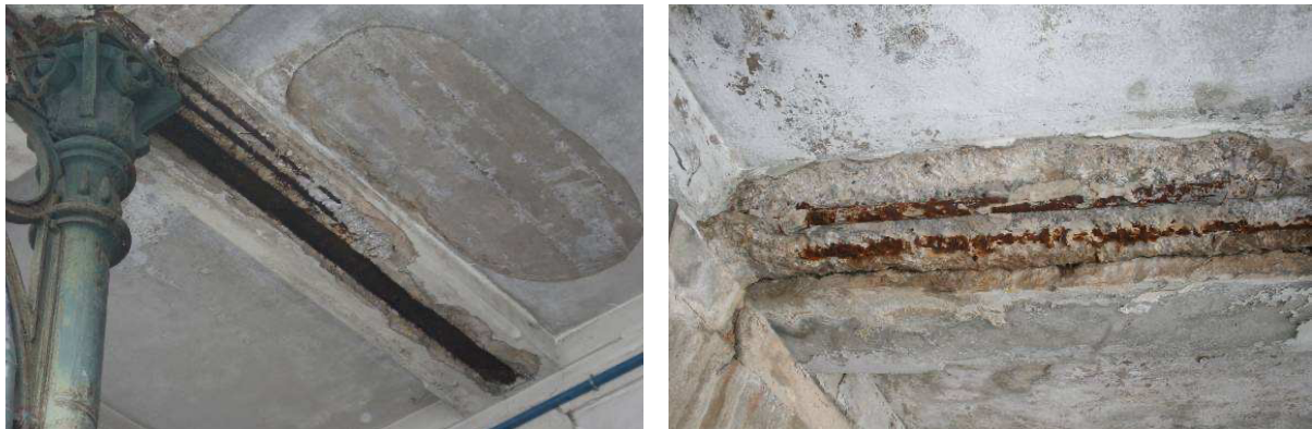
Figura 32 e 33: Corrosão nas armaduras do betão
