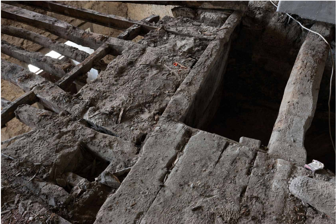
Figura 41: Degradação nos pavimentos de madeira
