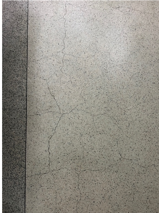
Figura 49: Fissuras no pavimento em marmorite
