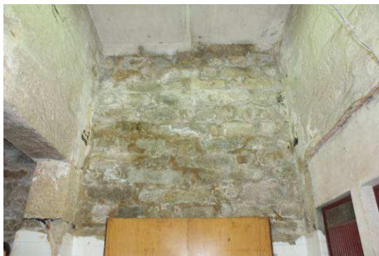
Figura 34: Humidade nas paredes de alvenaria de pedra
