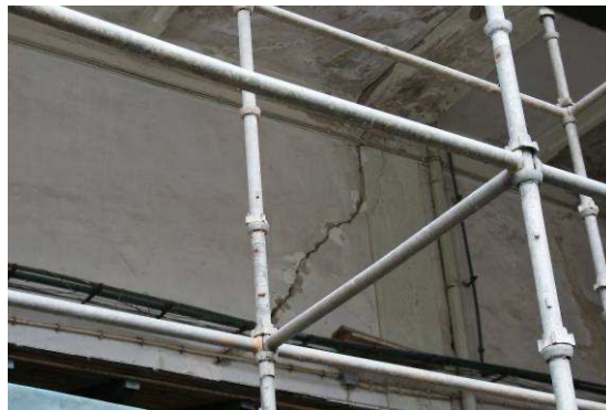
Figura 35: Fissuras em alvenaria de pedra
