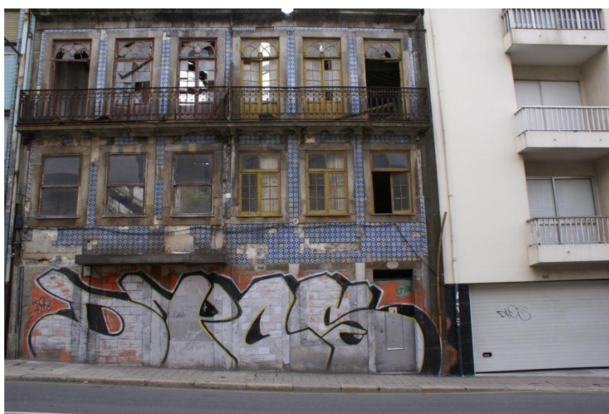
Figura 1 – Exemplo de degradação do edifício Fonte: Própria – Rua de Santa Catarina, Porto
