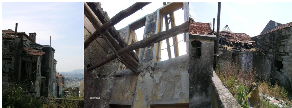
Figura 107 – Diversas vistas onde se pode observar o estado de degradação dos edifícios. Fonte: Fotos cedidas pelo gabinete Minimalinea.
