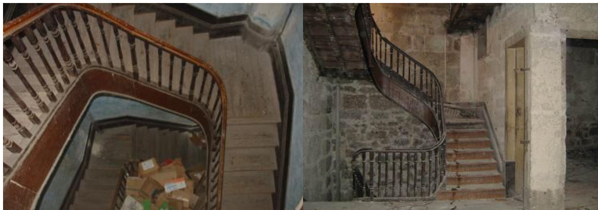
Figura 138 – Fotos do estado de conservação da caixa de escadas Fonte: Foto cedidos pelo gabinete Floret Architectura
