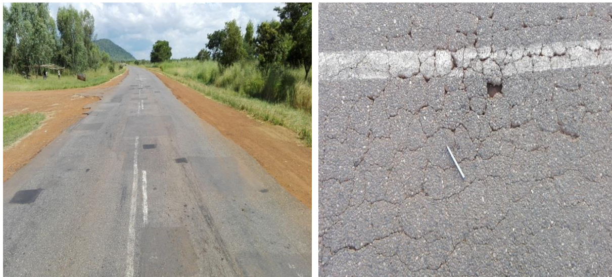
Figura 18 – Subsecção em Ruptura – R1 (74+000 a 77+000) [Fotos: Roughton International Ltd.]
