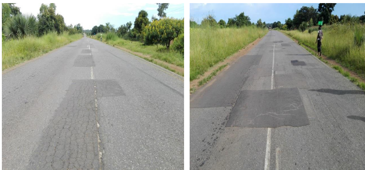
Figura 19 – Subsecção em ruptura – R2 (95+000 a 97+000) [Fotos: Roughton International Ltd.]
