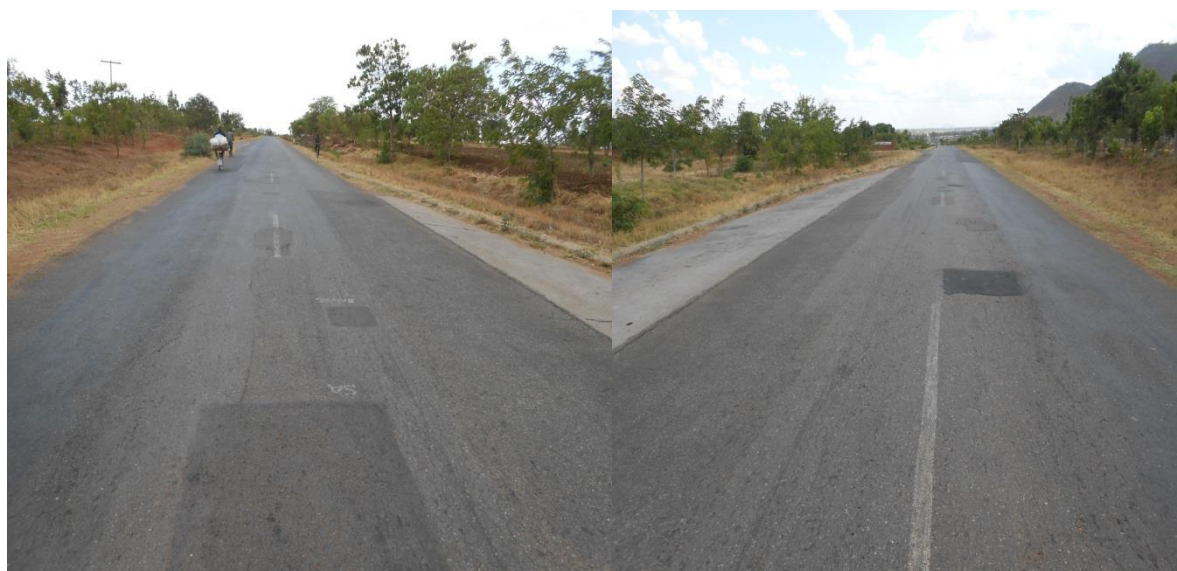
Figura 20 - Subsecção em ruptura – R3 (103+000 a 105+000) [Fotos: Roughton International Ltd.]
