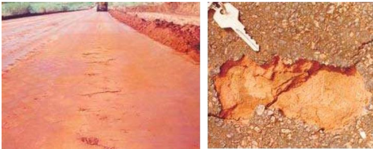
Figura 5– Defeitos relacionados com a excessiva compactação de materiais lateríticos argilosos (Nogami & Villibor, 2009).
