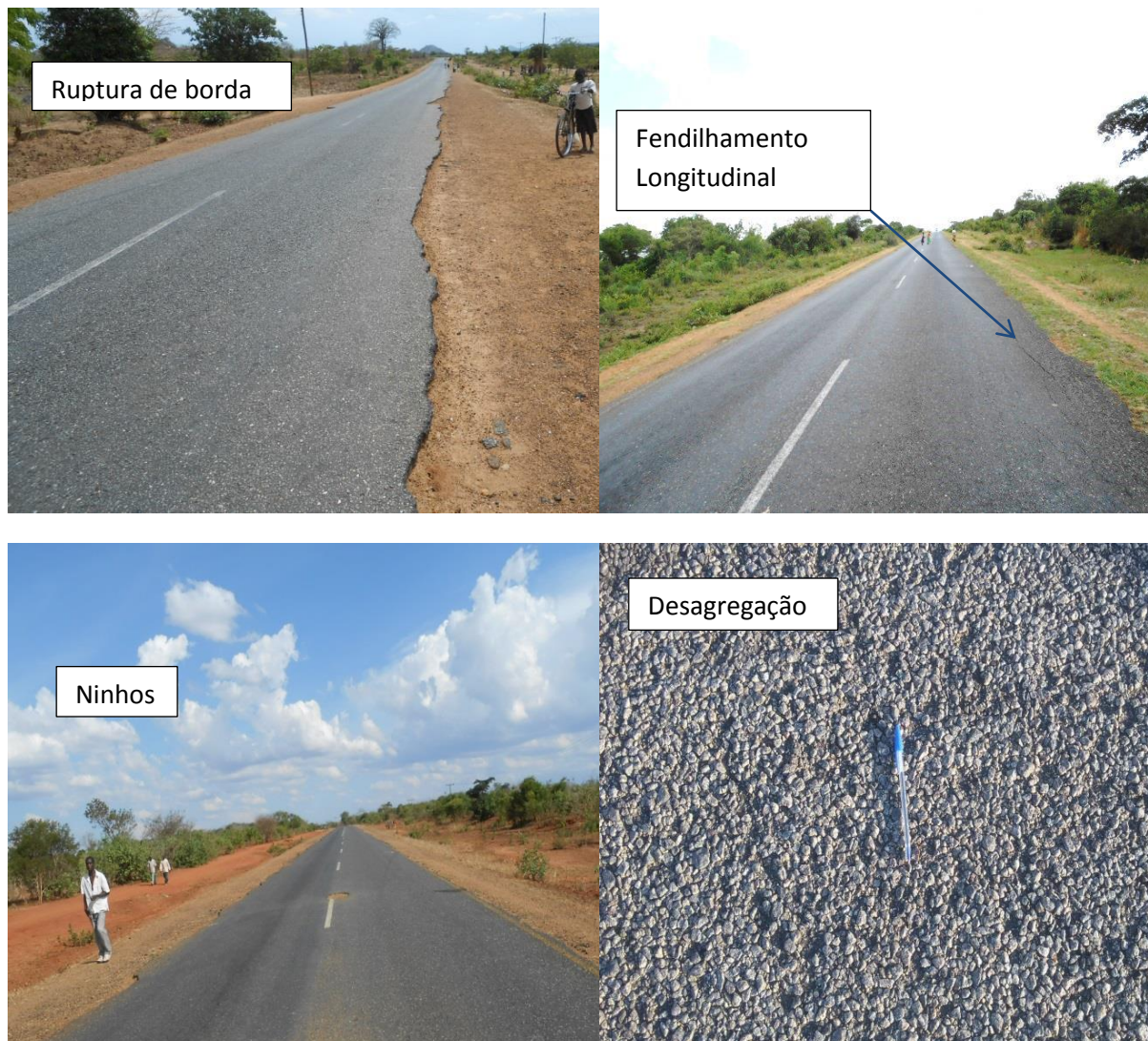
Figura 15 – Algumas degradações comuns encontradas na rodovia M1. [Fotos: Roughton International Ltd.]
