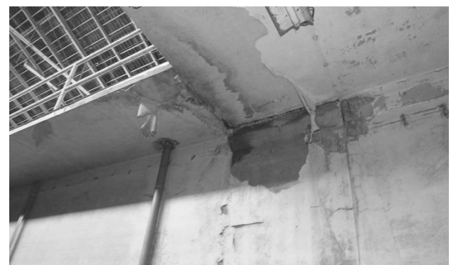
Fig. 167 – Patologia presente na laje.
