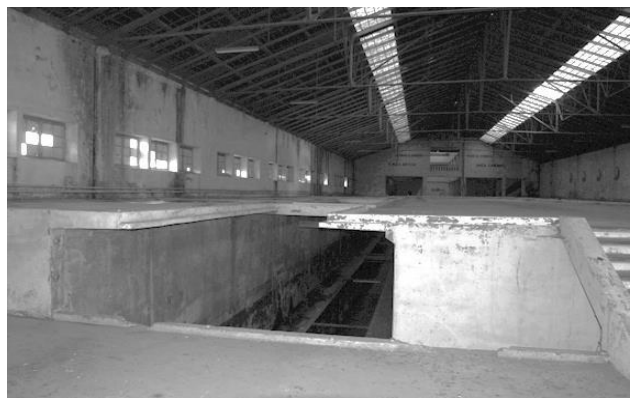
Fig. 172 – Desfasamento entre os pisos.
